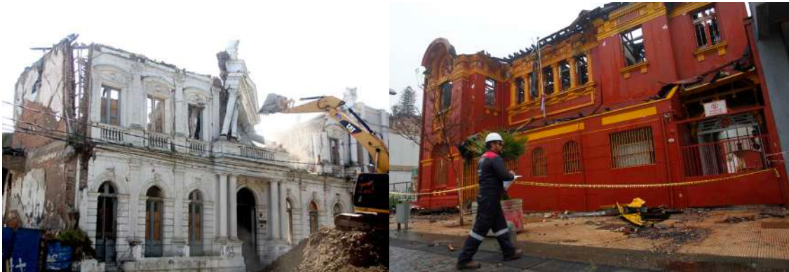
Figs. 1 y 2. Demolición del Club la Unión. Curicó (Chile). 2016. ©Diario de la Región del Maule e incendio del Club de Infantería Naval. Viña del Mar 2018. © Radio Agricultura.
